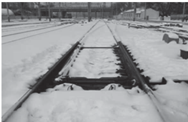
Рис. 5. Вид обогреваемого стрелочного перевода Fig. 5. Type of heated switch
