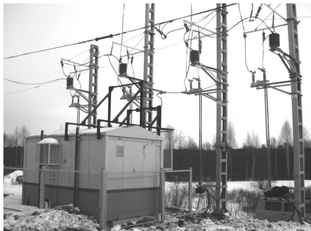
Рис. 3. Реконструированный ПС на разъединителях на ст. Кизнер (Горьковская железная дорога)
