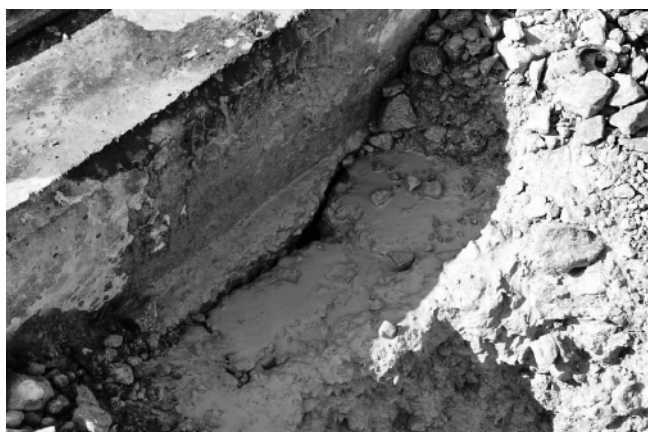
Рис. 12. Зазор между бетонной плитой и ГСНС
