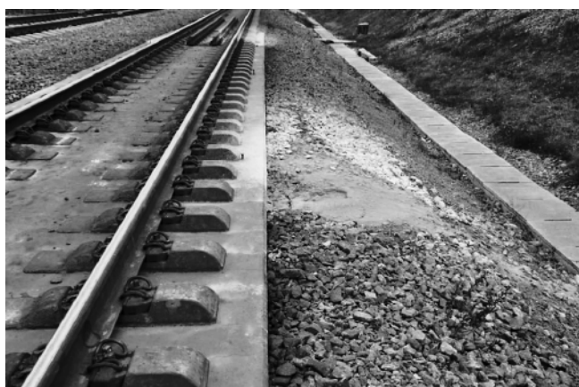
Рис. 11. Выплески цементной смеси из-под плиты
