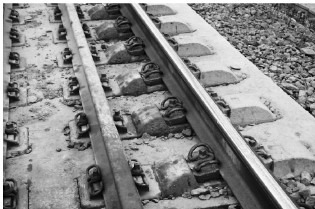
Рис. 10. Отрыв полушпалков от бетонной плиты
