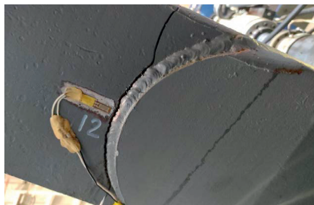
Рис. 10. Трещина в нижнем листе боковины в районе сварного шва соединения нижнего листа с усиливающей накладкой
