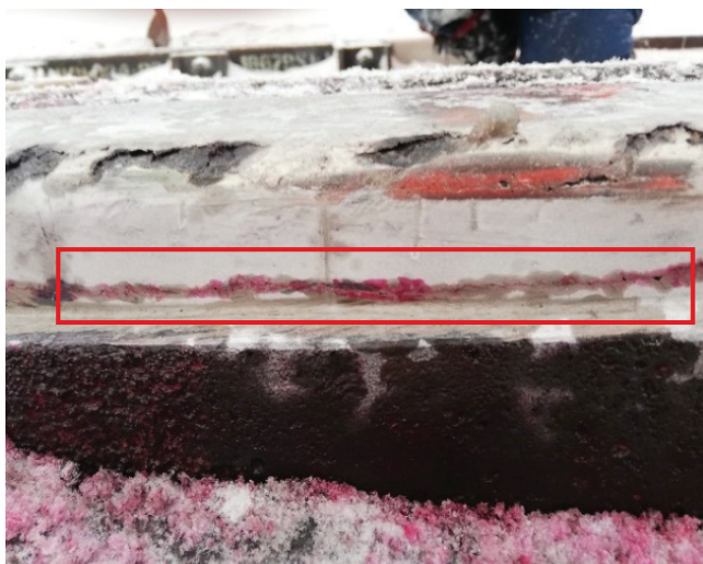
Рис. 13. Результат проверки трещины методом цветной дефектоскопии, подозрение на дефект ДС.30Г.2 [12, с. 155]
