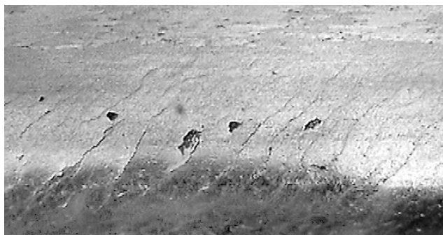
Рис. 10. Сетка косых трещин на выкружке наружного рельса в кривой
