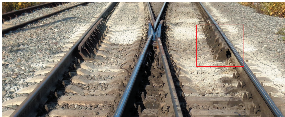
Рис. 3. Стрелочный перевод типа Р65, марки 1/11, оборудованный опытными подкладками* * Фото автора
